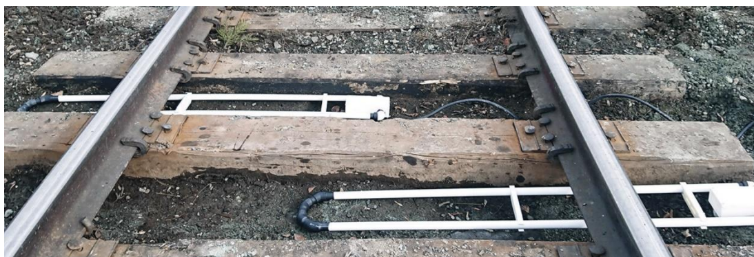
Рисунок 3 – Датчики ДКС на перегоне Баженово – Муранитный Свердловской дороги[5]
