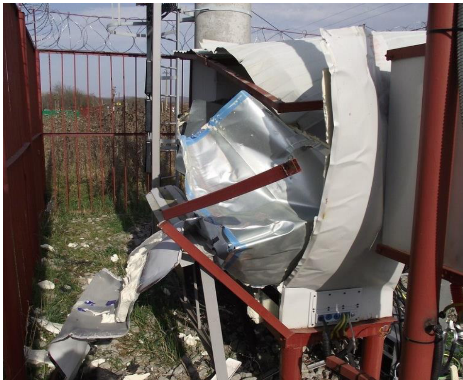
Рисунок 3. Последствия взрыва климатического телекоммуникационного шкафа
